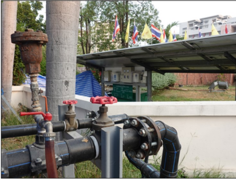
หัวจ่ายน้ำดับเพลิง ที่ตั้ง: ประตูทางเข้าหน้าโรงเรียน
