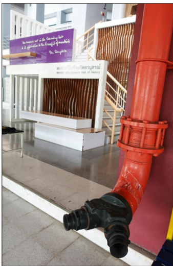
หัวรับน้ำดับเพลิง ที่ตั้ง: หอพักชาย อาคาร 9
