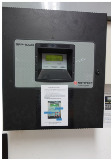
ตู้แสดงเหตุเพลิงไหม้ ที่ตั้ง: อาคาร 3 ชั้น 2 หน้าห้องน้ำ
