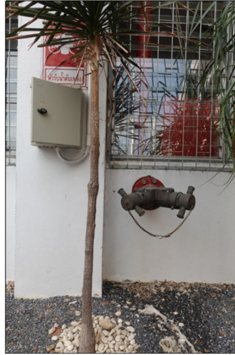
หัวรับน้ำดับเพลิง ที่ตั้ง: อาคาร 1 ชั้น 1 (ด้านลานเอนกประสงค์)
