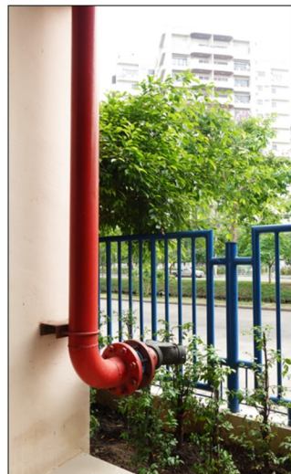
หัวรับน้ำดับเพลิง ที่ตั้ง: เรือนรับรอง อาคาร 14
