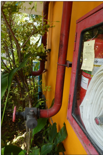
หัวรับน้ำดับเพลิง ที่ตั้ง: ศูนย์วิทยบริการ (ด้านโรงฝึกงาน)
