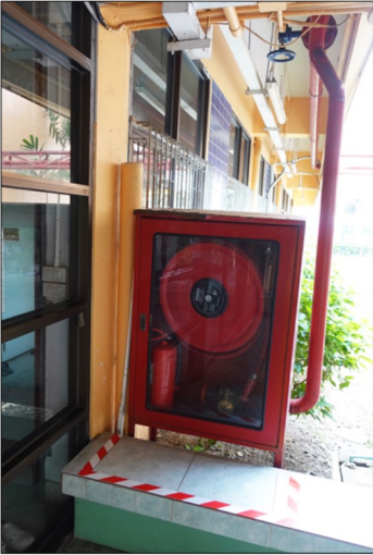
ตู้น้ำดับเพลิง ที่ตั้ง: หอพักหญิง อาคาร 8
