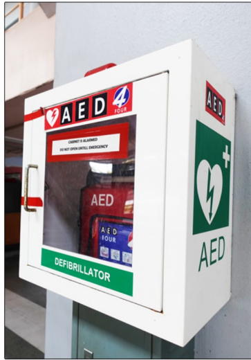
ตู้ AED (Automated External Defibrillator) (เครื่องกระตุ้นหัวใจภายนอกอัตโนมัติ) ที่ตั้ง: โถงหอพักชาย อาคาร 9 ชั้น 1
