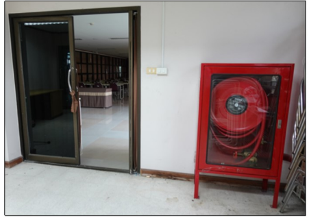
ตู้น้ำดับเพลิง ที่ตั้ง: หอประชุมชั้น 2 ด้านห้องเก็บของ
