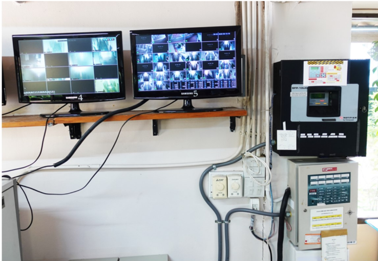
สัญญาณทีวีวงจรปิด ตู้แสดงเหตุเพลิงไหม้ (ขวามือ) ที่ตั้ง: ห้องสำนักงานหอพัก อาคาร 10 ชั้น 1
