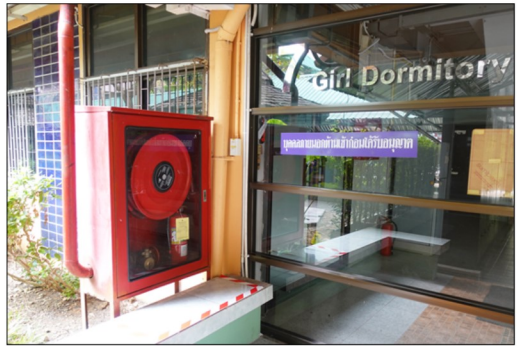
ตู้น้ำดับเพลิง ที่ตั้ง: หอพักหญิง อาคาร 7
