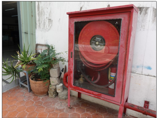
หัวรับและตู้น้ำดับเพลิง ที่ตั้ง: โรงฝึกงาน
