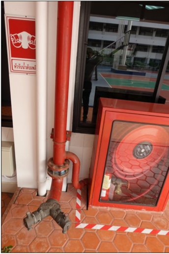
หัวรับและตู้น้ำดับเพลิง ที่ตั้ง: อาคาร 3 ชั้น 1 (ด้านลานเอนกประสงค์)
