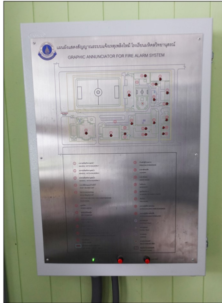
ตู้แสดงสัญญาณระบบแจ้งเหตุเพลิงไหม้ทั้งโรงเรียน ที่ตั้ง: ห้องควบคุมในห้องประชาสัมพันธ์ อาคาร 3 ชั้น 1
